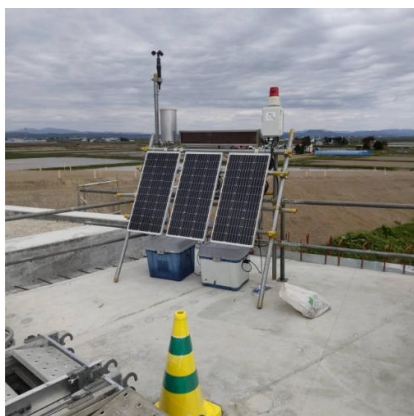
太陽光電源装置
