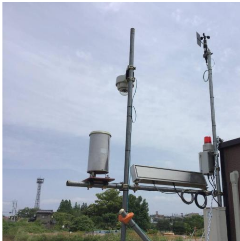
気象観測装置 警報装置 現場カメラを取付。100V商用電源で機器は稼働します。
